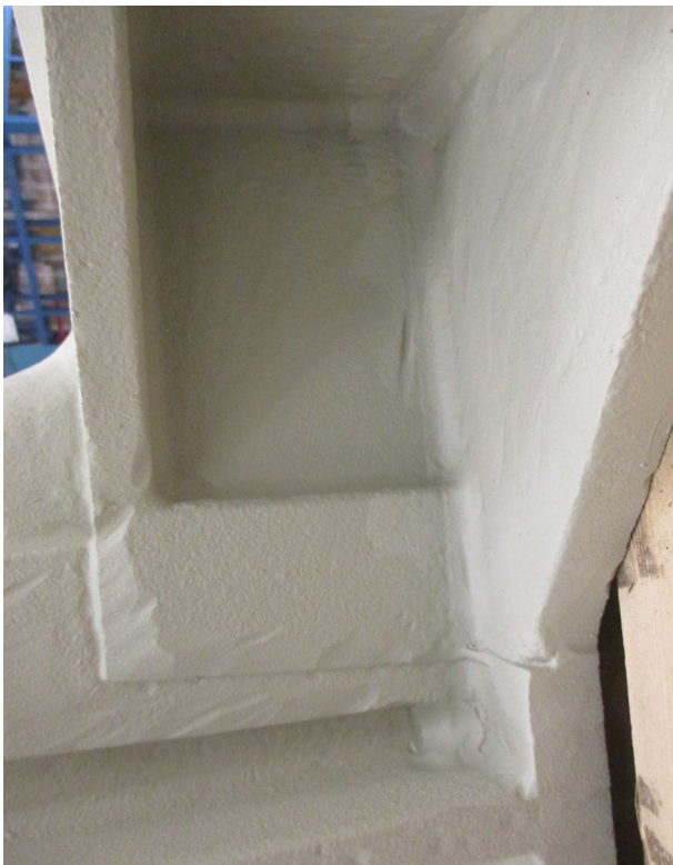
Einschnürung Übergang, Bearbeitungsspuren
